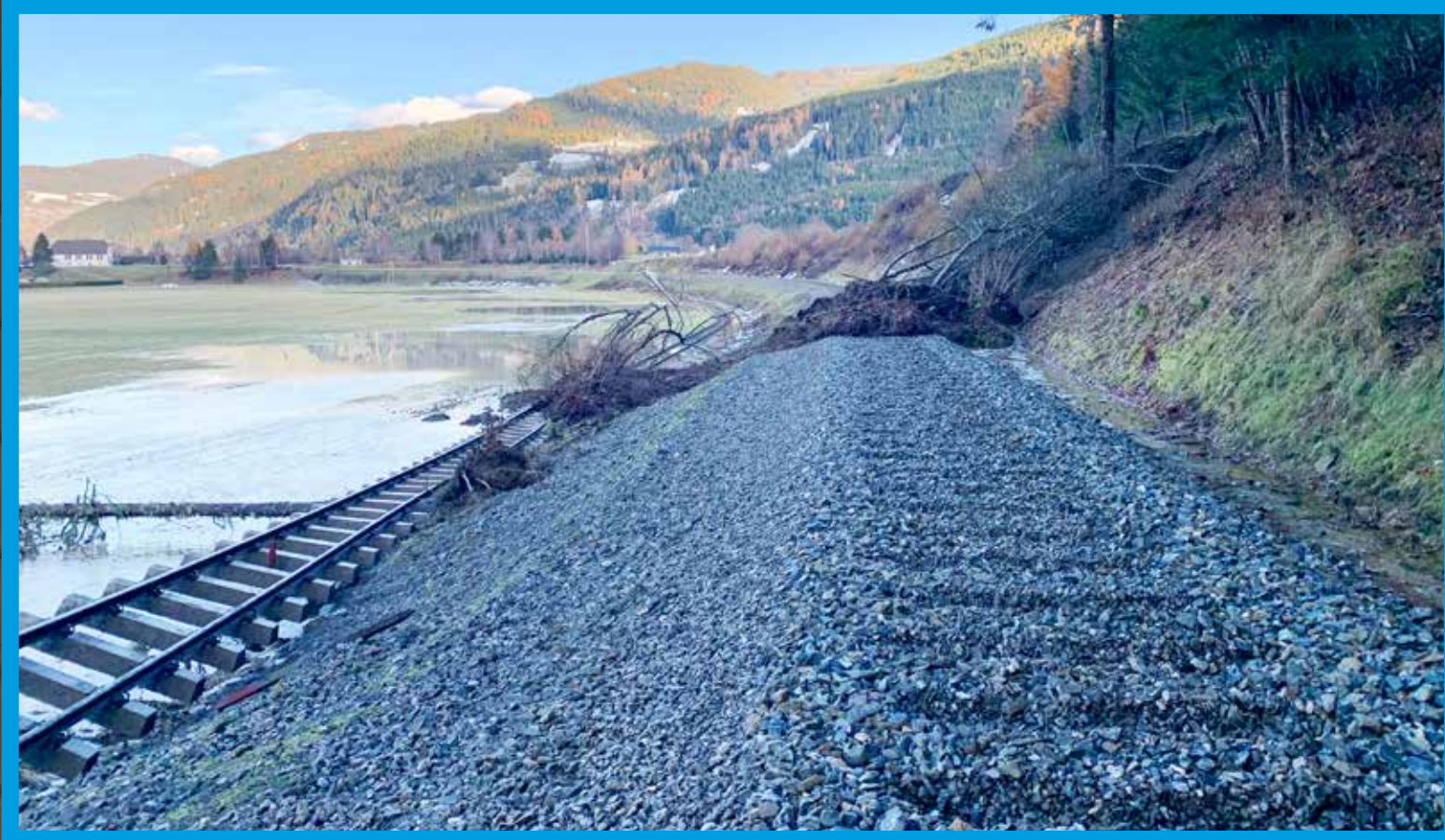
Versetztes Gleis der Murtalbahn infolge eines Murenabgangs bei Stadl an der Mur im November 2019.
